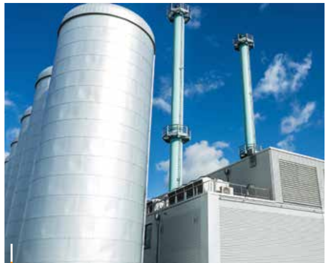
Blockheizkraftwerke nutzen die Energie besonders effizient, da sie Strom und Wärme sowie Kälte produzieren.
