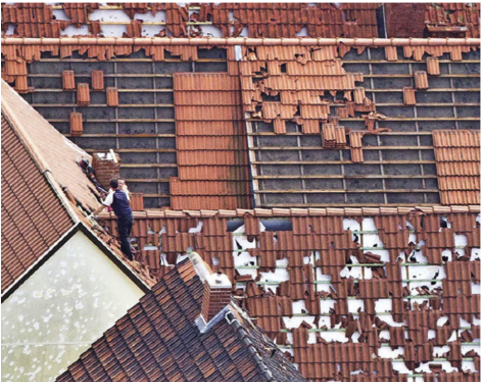
Bei Hagel können Dachziegel und Dachfenster brechen.
